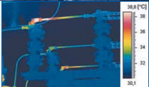
Utlenienie wyłącznika WN
