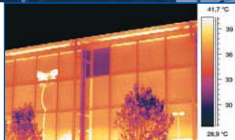
Brak jednej szyby w układach dwu szybowych
