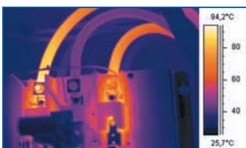
Złe połączenie oraz uszkodzenie wewnętrzne
