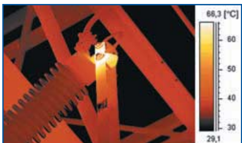
Złe zabezpieczenie połączenie
