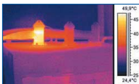
Obluzowane połączenie kablowe
