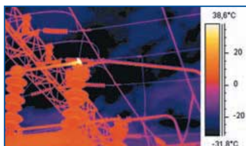
Złe połączenie instalacji WN
