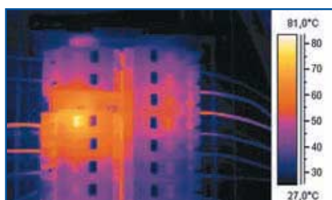
Wewnętrzne uszkodzenie obwodów
